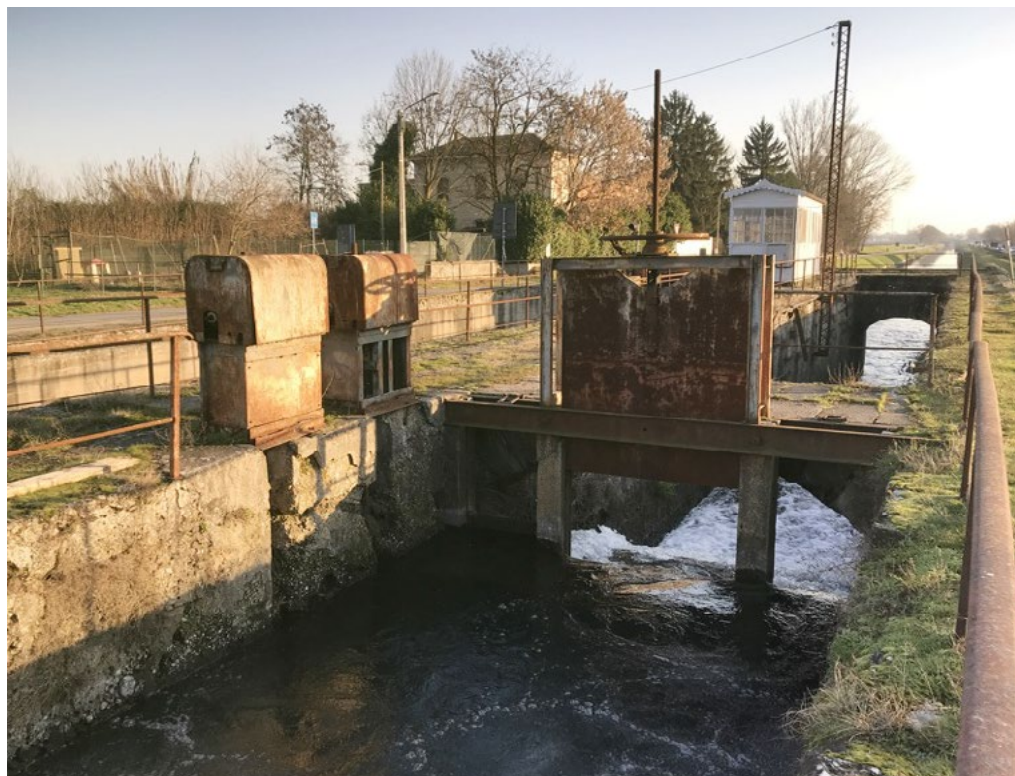
3: Vista della Conca del Cassinino (ultima conca del comune di Pavia). Si tratta di una delle poche in cui si sono conservati tutti gli elementi originari, anche se la mancata manutenzione e la continua esposizione all'acqua e agli agenti atmosferici li hanno resi inutilizzabili. Sullo sfondo si nota in bianco la cabina di comando, sottoposta ad un recente restauro (2021). Foto dell'autore, marzo 2021.
