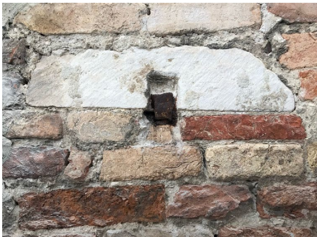
2: Esempio di legamento muratura – solaio, meglio noto come "fiuba". Nell'immagine si vede l'elemento metallico di connessione che si aggancia all'elemento in pietra d'Istria. Sestiere di San Marco, foto dell'autore, 2021.
