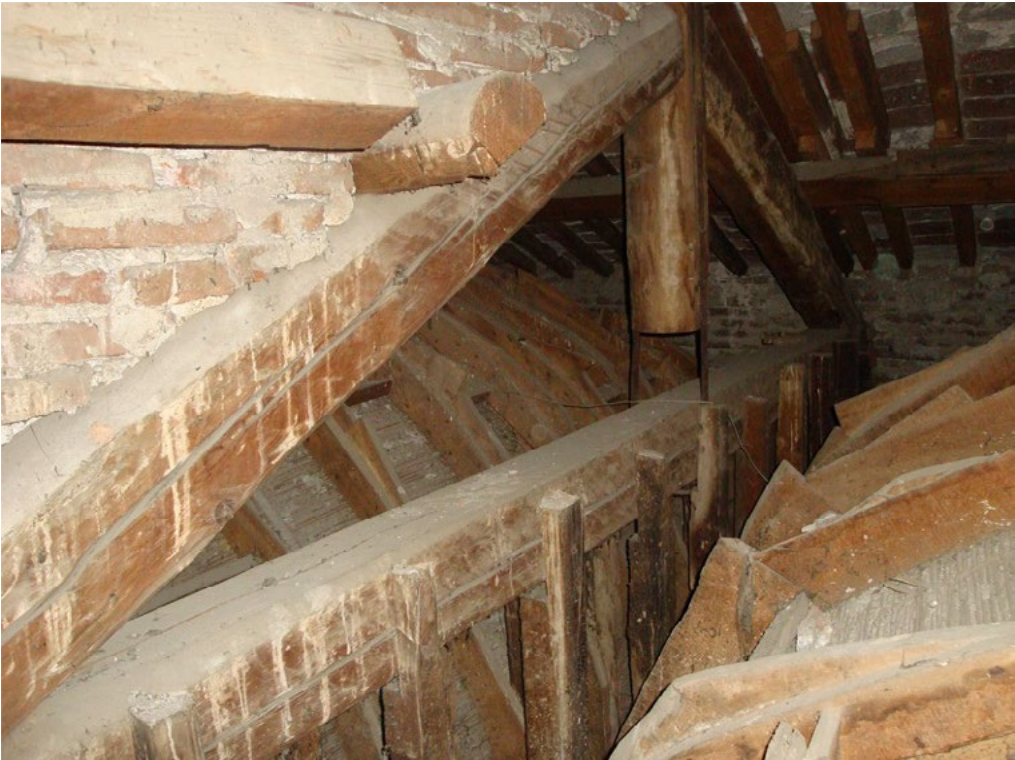
5: La capriata che sorregge le due volte in cannucciato che coprono il vano dello scalone e l'atrio del primo piano; essa corrisponde all'architrave divisoria delle due coperture a padiglione anzidette. Olimpia Di Biase, 2020.
