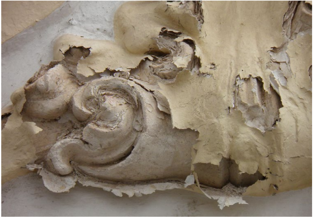
3: Stucco detail, Rua de São Francisco, Elvas, 2021 [Photo: Patrícia Monteiro].
