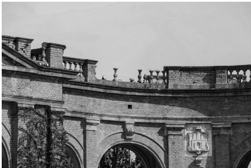
5: Mirogoj, danni causati dai due terremoti nel marzo e dicembre 2020 al sito. Oltre ai danni strutturali, sono stati gravemente danneggiati tombe, padiglioni e i portici.
